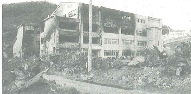
火災にあった鉄筋コンクリート造りの小学校
