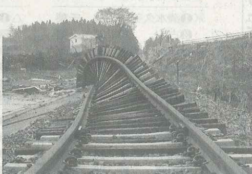
引き波により反転した線路
