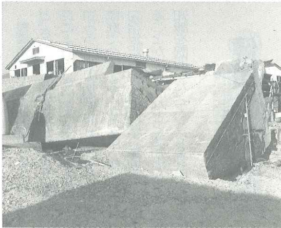
転倒した防潮堤
