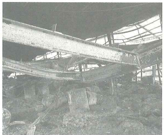
火災にあった鉄骨造りの建物
