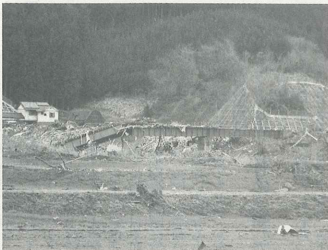
被害を受けてケタが落ちてしまった陸橋
