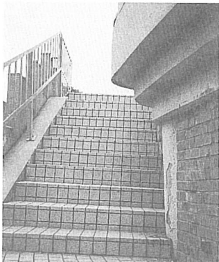
写真11 階段の上に突き出した壁。視覚障害者や注意を怠った一般歩行者にとって危険である
