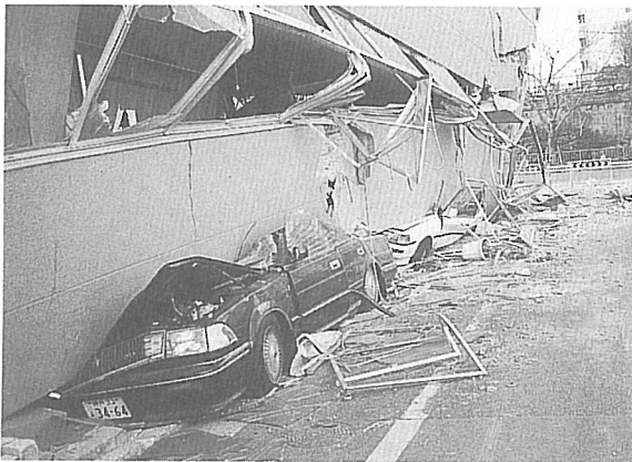
写真16 被災した集合住宅。 1階部分をピロティにして駐車 車場として利用していたが圧 壊した
