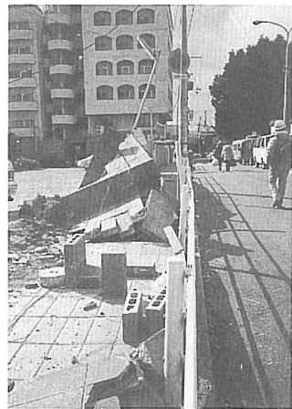
写真1▶ 道路上に倒れた ブロック塀
