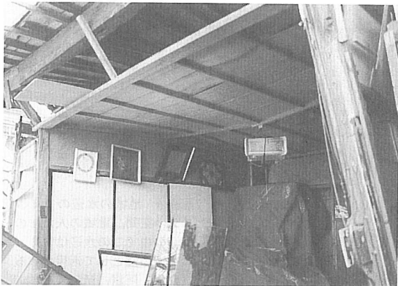
写真3 倒壊した住宅の内部。内装材や家具の破損や転倒によっても大きな被害が生じた
