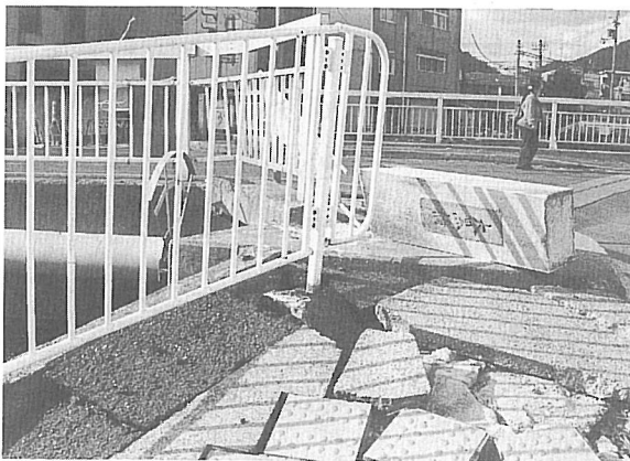
写真5 破損した 点字ブロック
